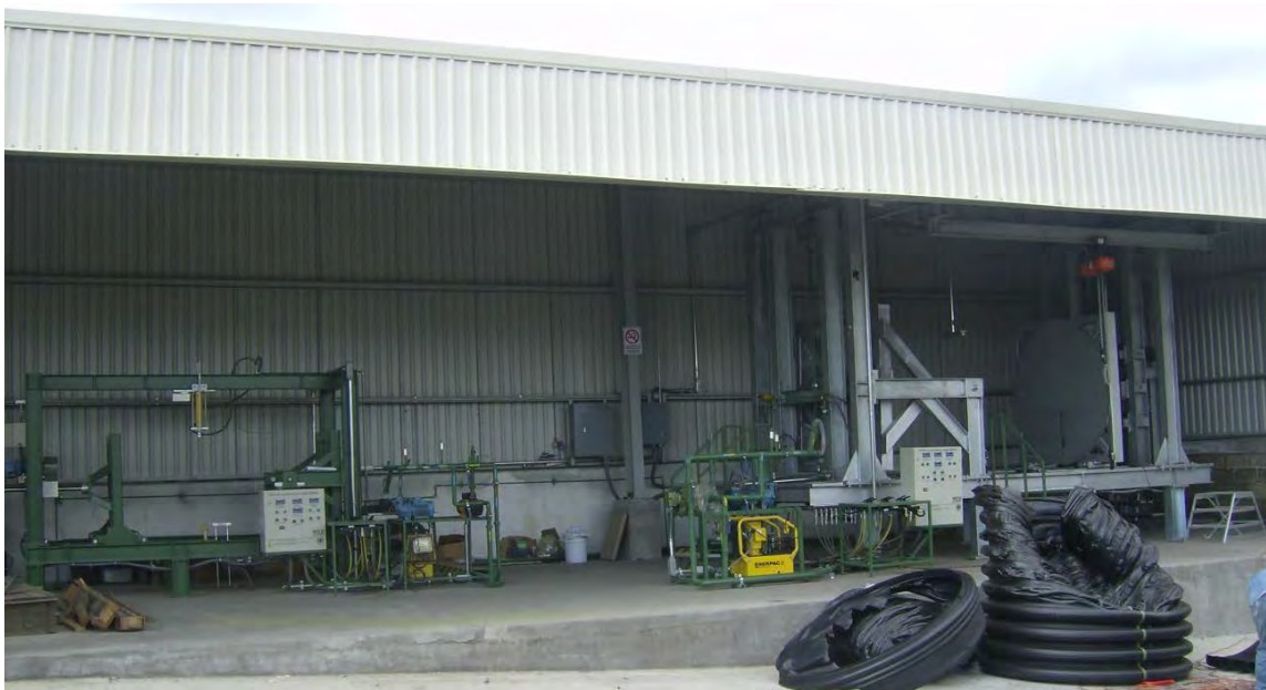
Figura 4.73. Vista general de la nave y de los equipos, EPH-60 y EPH-24, instalados de la planta Jilotepec.
