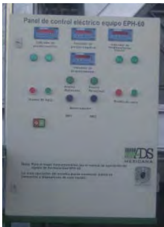
Figura 4.62. Panel de control eléctrico.
