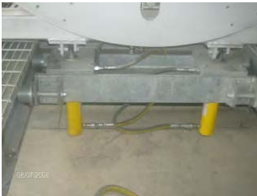
Figura 4.53. Elementos de desalceamiento.
