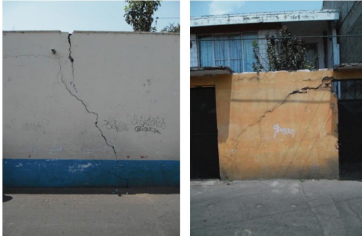
Figura 1.5 Grietas en las calles de San Antonio Tecómitl
