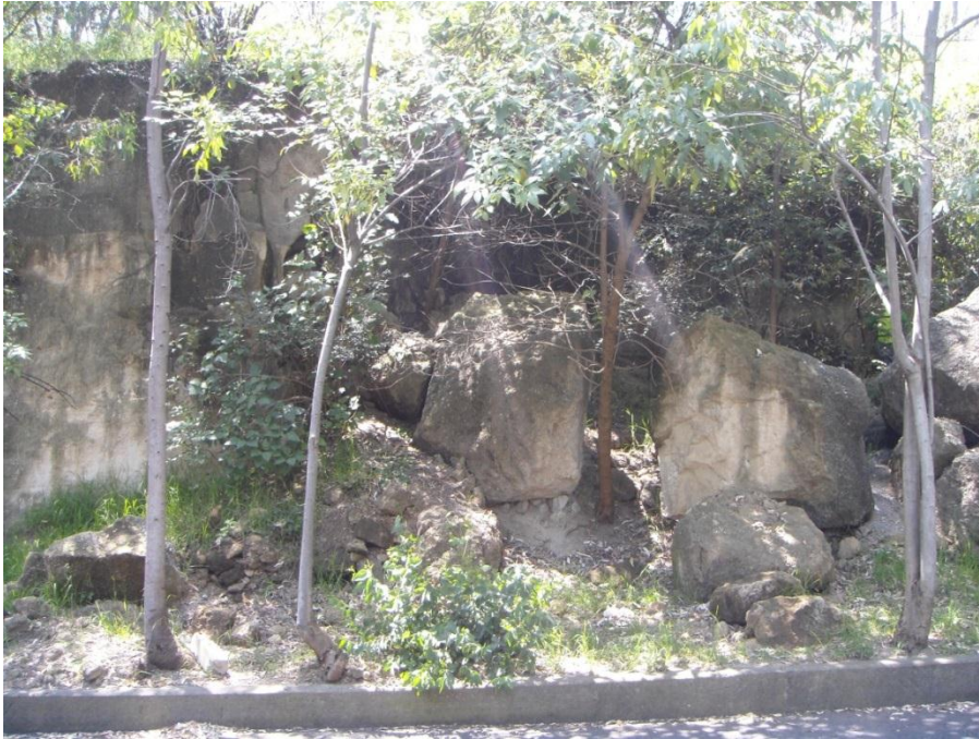
Fig. 1.7 Ejemplo de un desprendimiento de roca a lo largo de la cara Norte del talud.
