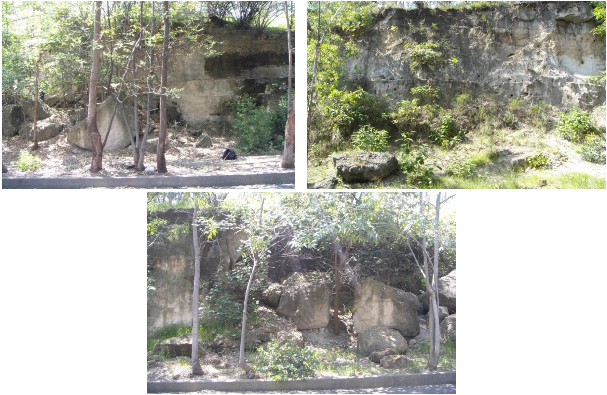
Figura 1.3 Caídos presentes a lo largo del talud ubicado sobre el circuito de la avenida Joaquín Clausell, a un lado de la Barranca de Dolores.
