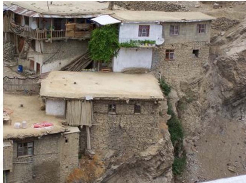
Vivienda en zona de alto riesgo
