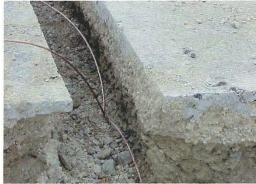
Fig. 5.8 Conductores desnudos de puesta a tierra
