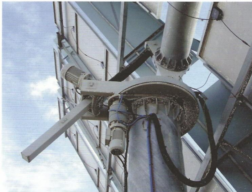
Fig. 3.23 Detalle de la parte superior del mástil de un seguidor a dos ejes. Se puede ver el motor encargado del movimiento azimutal y otro motor (un poco más arriba y a la izquierda del primero) que actúa girando el eje horizontal del seguidor, para variar el ángulo de inclinación.
