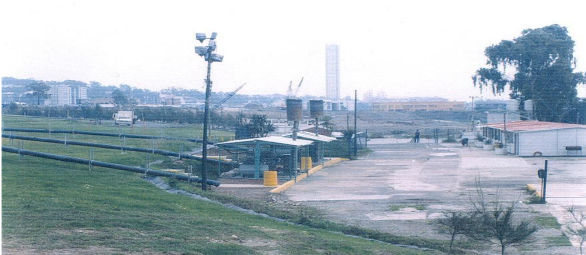
Figura. 6. Quemadores de biogás ( 650 \text{ ft}^3/\text{min} ) instalados en 1999 en el extiradero Prados de la Montaña. Fuente: Colección fotográfica DGSU.
