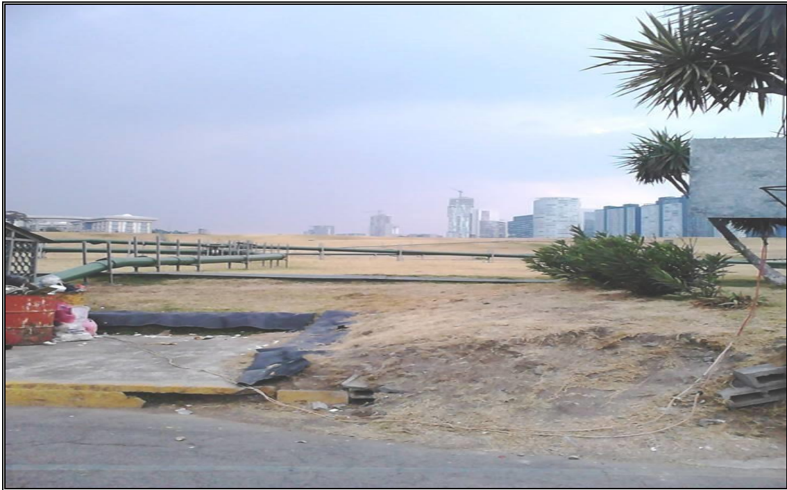
Figura. 15. Red de extracción y soportes de tuberías en Prados de la Montaña. Fuente propia
