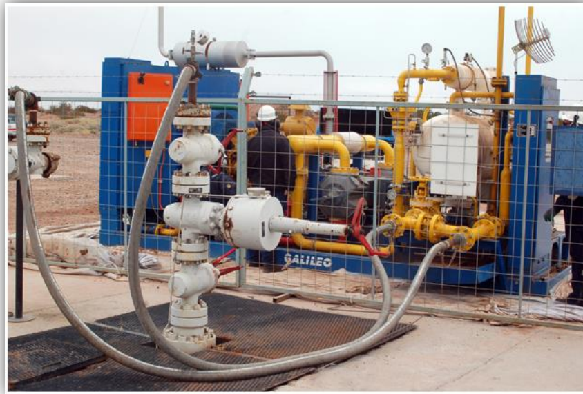
Figura 4.4 Mini compresor conectado a boca de pozo mediante mangueras flexibles (EPA, 2011).
