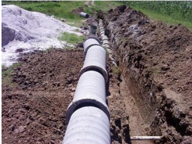
Fig.3.2 Infraestructura Urbana de Tlalpan, Drenaje.
