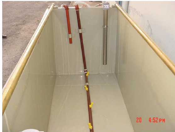
Figura 11. Tanque de PVC 20
