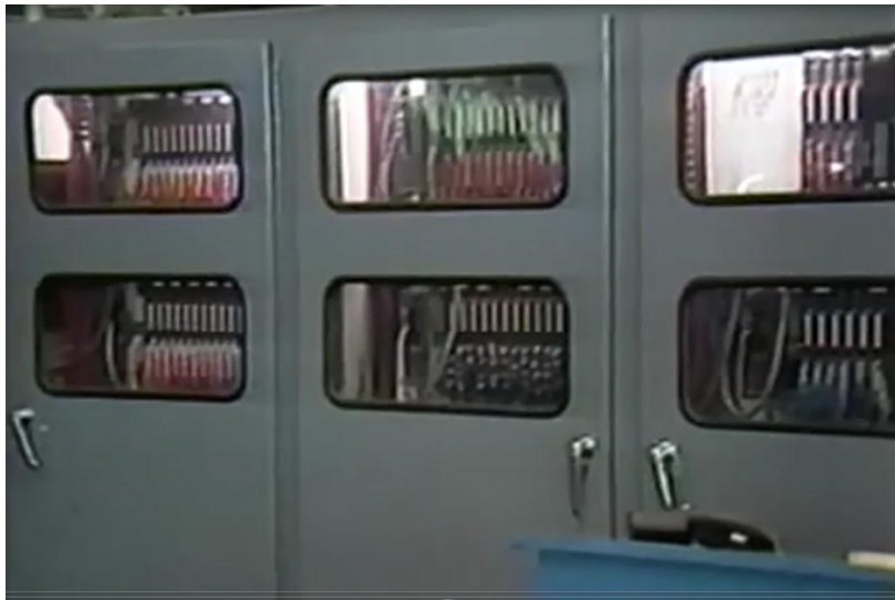
Fig 1.2 PLC dentro de su cabina.
