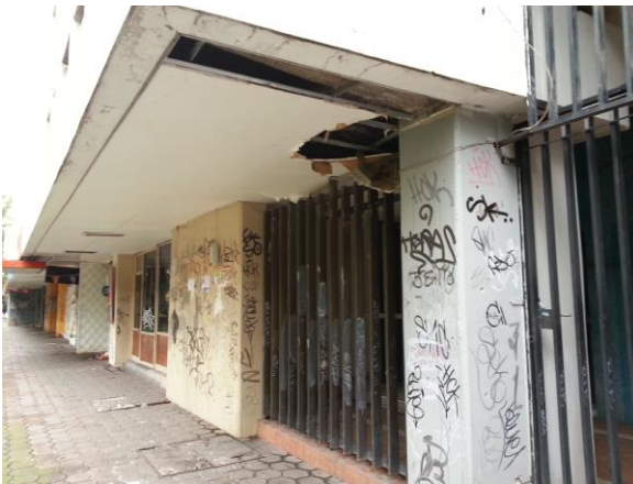
Fachada trasera del Presidente Juárez. Deterioro de plafones, muros grafitados, locales comerciales desocupados, basura, son parte del perfil de algunas zonas del conjunto.
