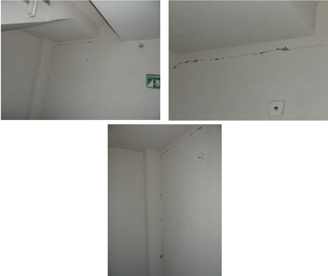
Fig. 2.13 Grietas de separación del muro de mampostería con elementos estructurales en el cubo de escaleras del nivel 4.
