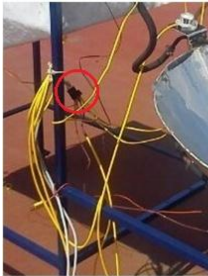
Figura 3.33. Centro de conexiones del desalador solar
