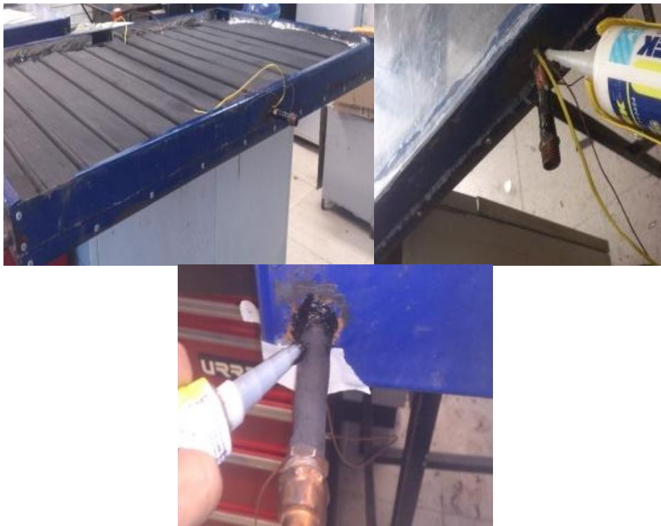
Figura 3.14. Sellado de salidas de aire de los calentadores
