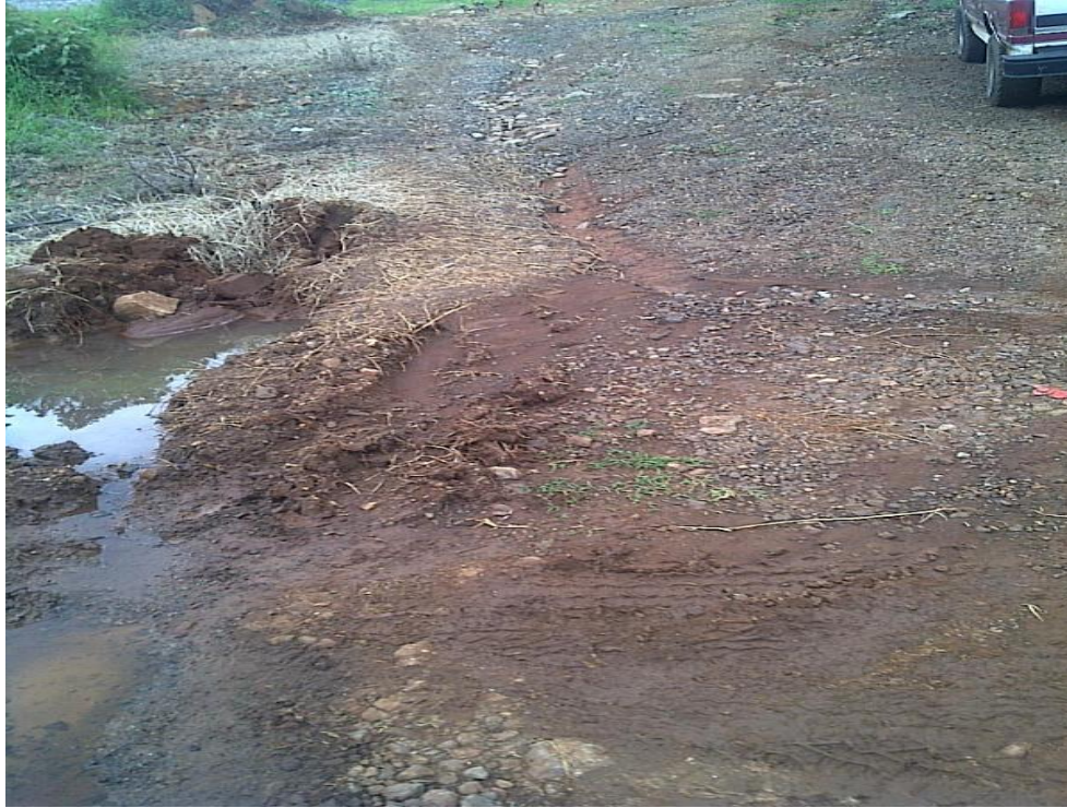
Imagen 3.8.- Socavaciones del camino.
