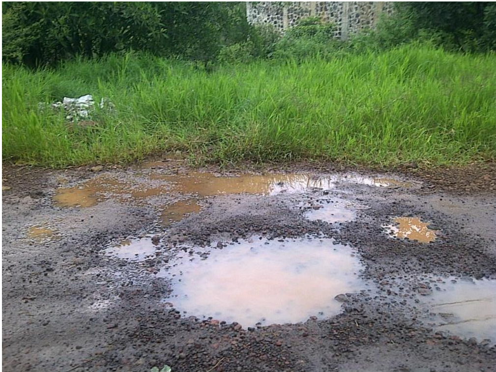
Imagen 3.5.- Deterioro por precipitación.
