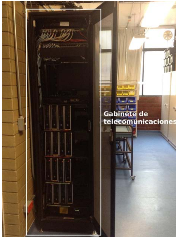
Figura 4.1: Gabinete de telecomunicaciones.
