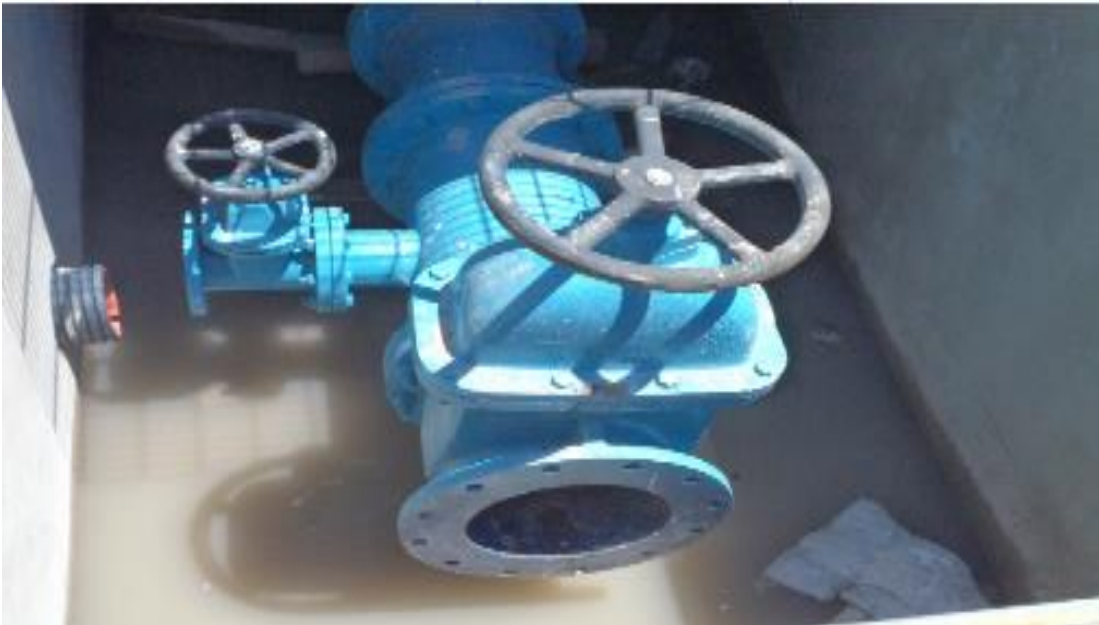
FOTO 6. Conexión del Sistema de velocidad Variable a la red de distribución.
