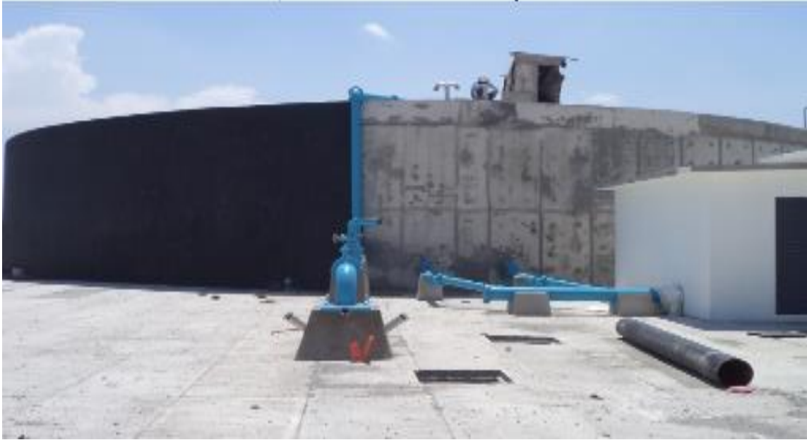
FOTO 1. Vista general de la cisterna (3, 000 m 3 ) y pozo (Q= 35 lps)
