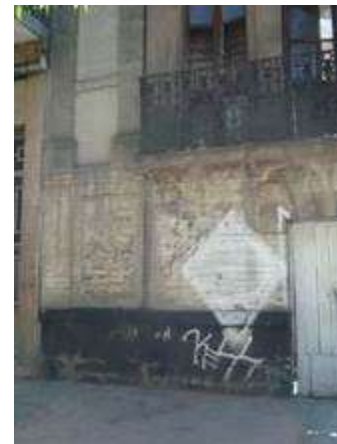
Graffiti parte inferior de fachada.
