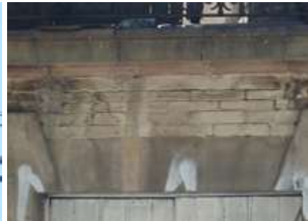
Presencia de humedad, debajo del balcón.
