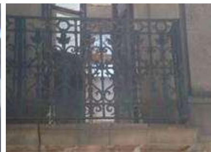
Oxido en la herrería del balcón.
