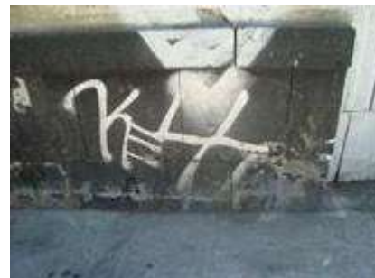
Graffiti en rodapié de fachada.
