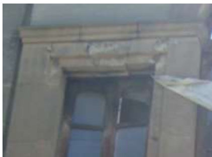
Presencia de humedad, en la clave y elementos de cantera.
