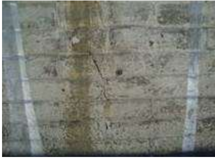
Fisura sobre muro.
