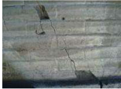
Faltantes de material final.
