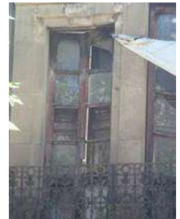
Carpinterías en mal estado.
