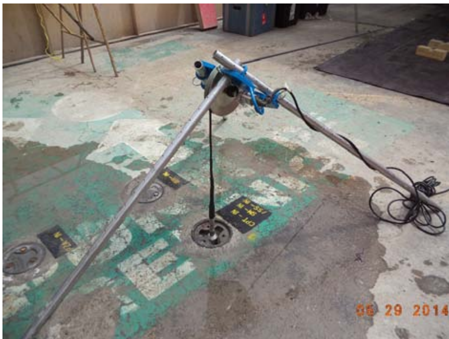
Figura A12. Equipo en operación.
