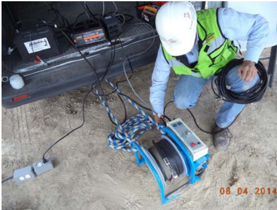
Figura A7. Conexión del cable que sujeta la sonda suspendida
