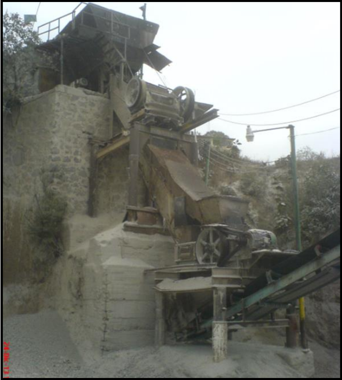
Figura 30. Estación de trituración
