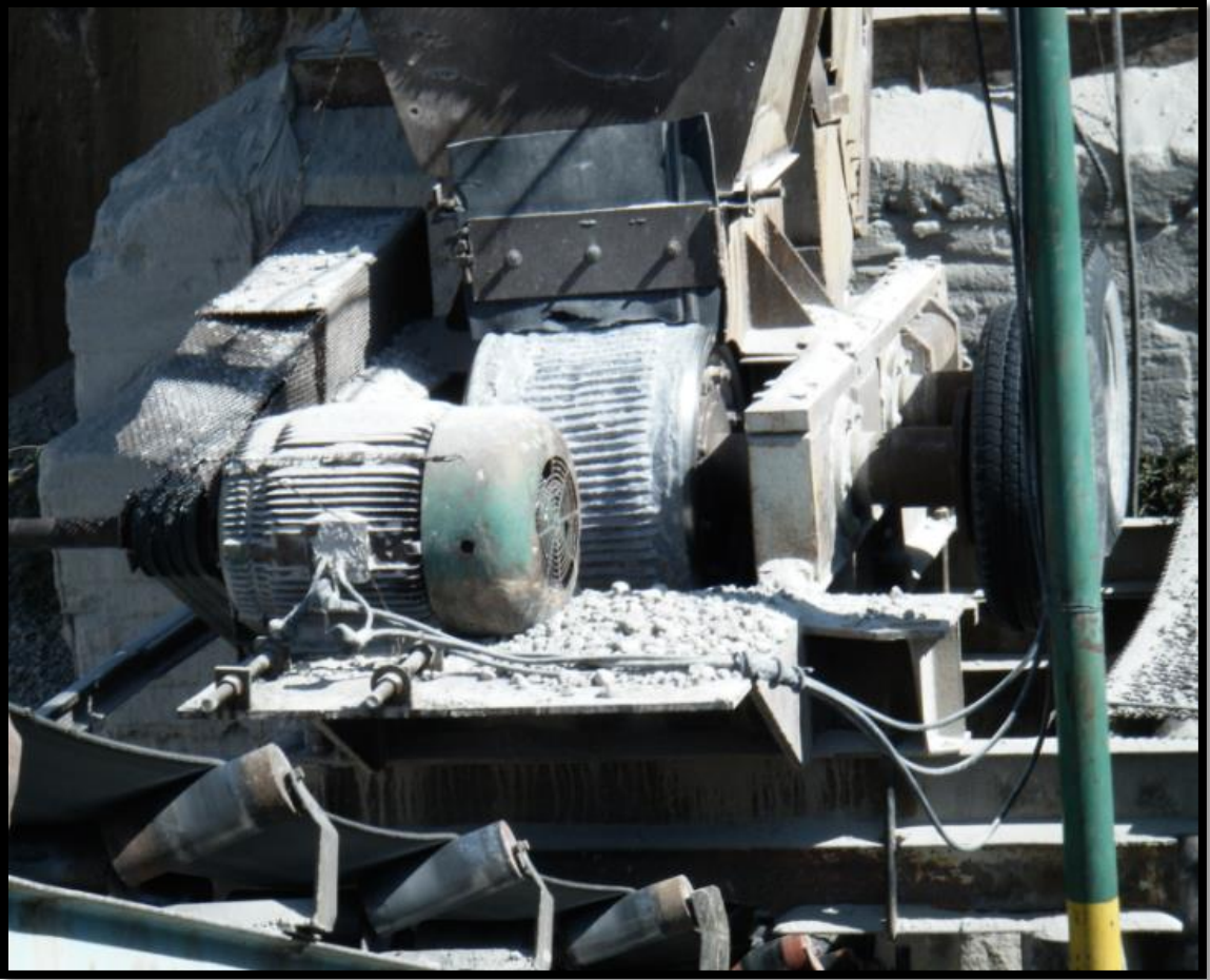
Figura 31. Molino de rodillos con exceso de desgaste
