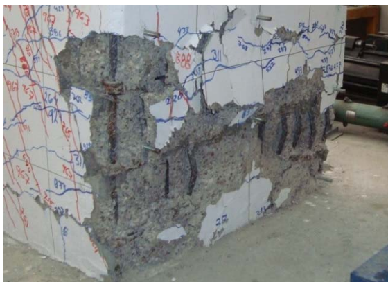
a) Pandeo de barras longitudinales
