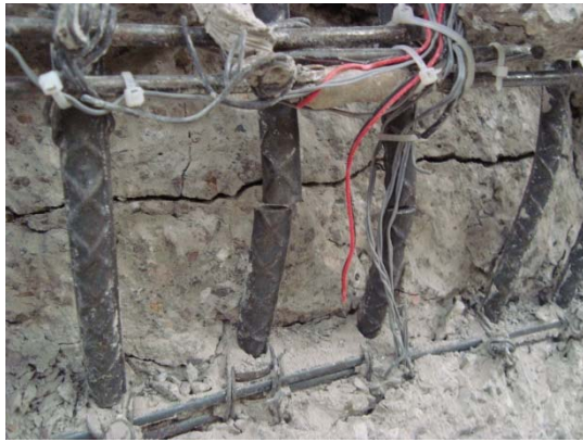
c) Fractura de barras longitudinales (Oeste)
