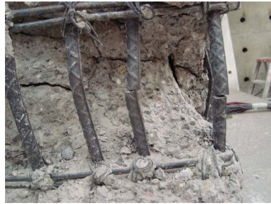
d) Fractura de barras longitudinales (Suroeste)
