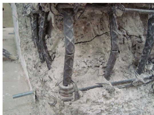
b) Fractura de barras longitudinales (Noroeste)
