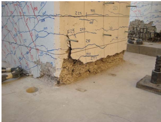
a) Pandeo de barras longitudinales cara Este
