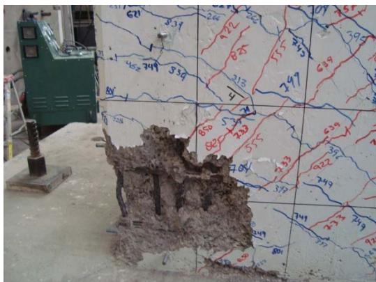
a) Pandeo de barras longitudinales
