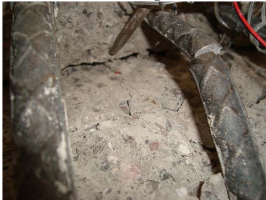
e) Fractura de estribo (Oeste)
