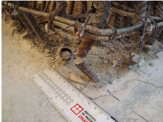
c) Fractura de barras longitudinales (Noreste)
