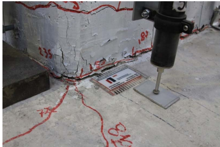
Figura 6.7. Deformación de la junta fría de concreto pila – zapata
