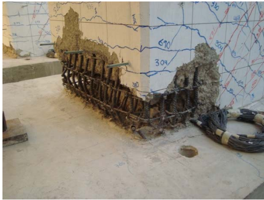
a) Pandeo de barras longitudinales cara Este
