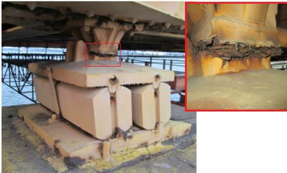
Figura 1.18. Daño en apoyo móvil del tramo metálico levadizo [1.3].
