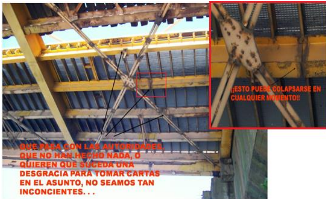
Figura 1.10. Ruptura del alma y patín superior en los largueros del tramo carretero [1.5].
