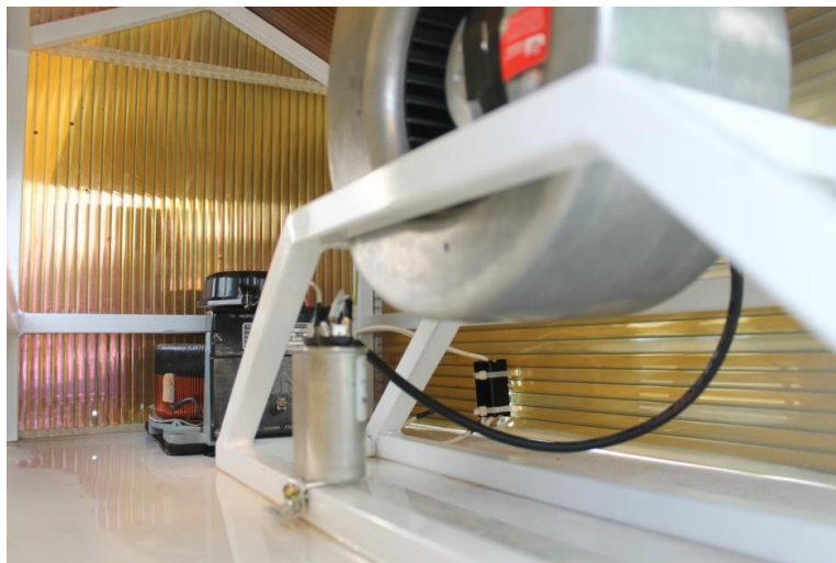
Figura 2.9 Autotransformador de voltaje conectado al ventilador inyector de aire
