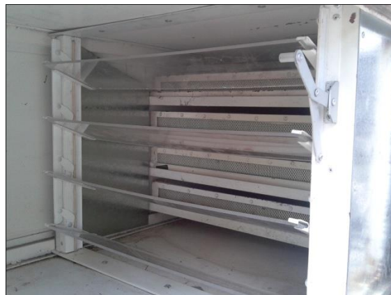
Figura 3.11 Adecuación de ventilas en la primer sección del secador para mejorar la distribución del aire caliente que entra en contacto con las primeras charolas.
