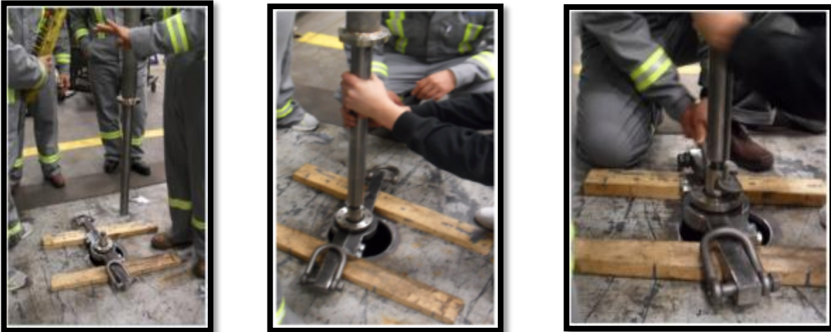
Figura 42. Acoplamiento del motor y bomba en el pozo.
