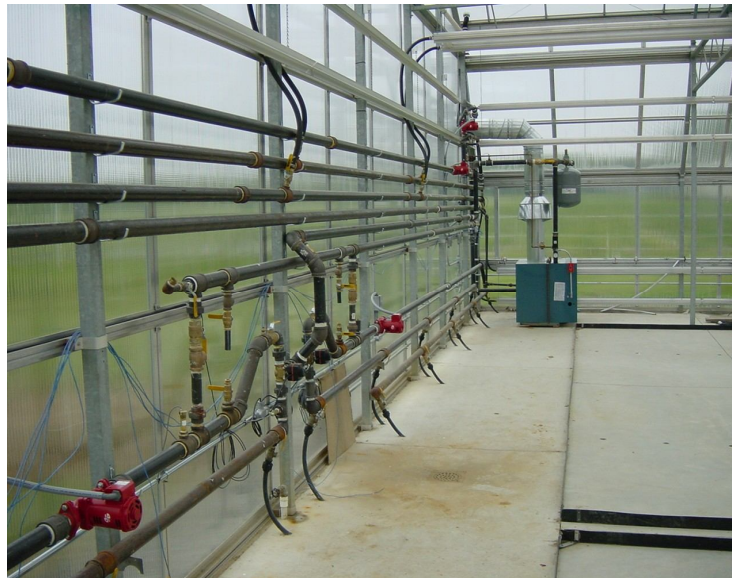
Figura 22. Sistema de calefacción por convección y radiación generado por la circulación de agua caliente en tuberías de hierro y polipropileno.
