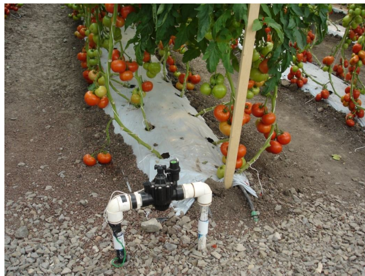
Figura 40. Válvula solenoide para el control del riego.
