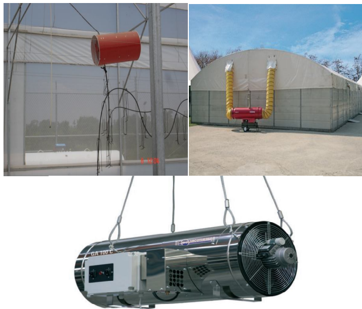
Figura 19. Generadores de aire caliente de combustión directa (cañón).
