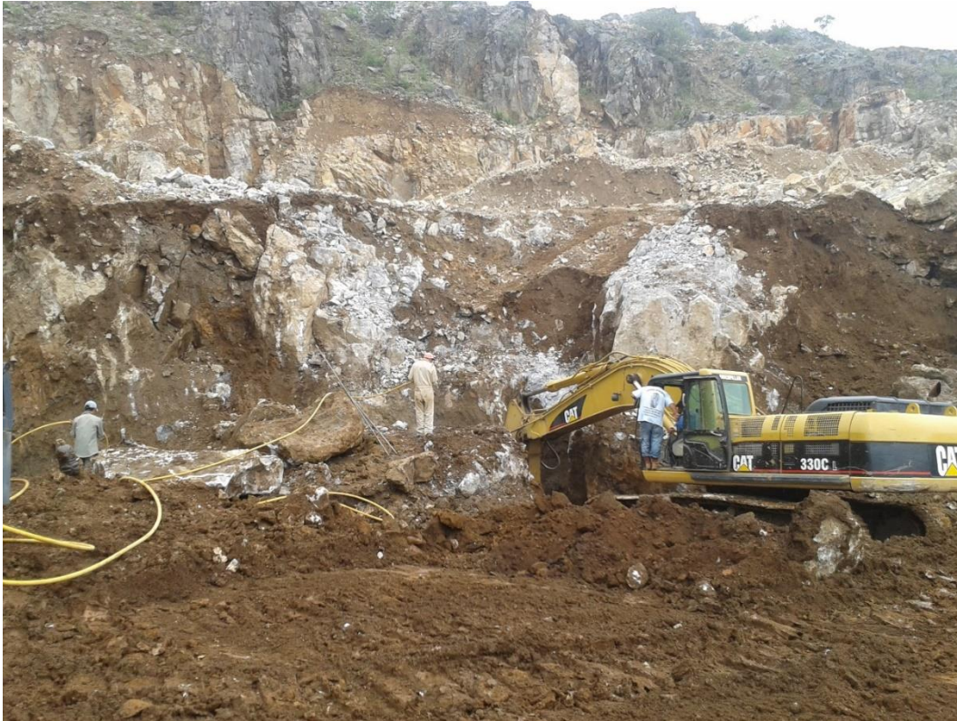
Figura IV- 11 Trabajos de explotación del área 1. La figura muestra las condiciones de trabajo, falta de una configuración geométrica del área y las condiciones que presenta la plataforma de trabajo.
