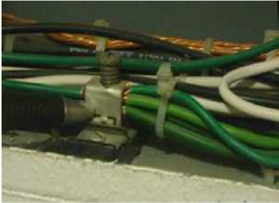
Figura 36. Cable de instalación de la red eléctrica
