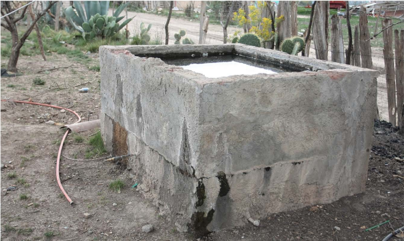
Fotografía 34. Almacenamiento de agua en pila de concreto sin tapadera
