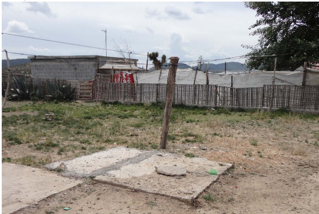
Fotografía 40 Fosa séptica sin ventila en una vivienda del Dieciocho.
