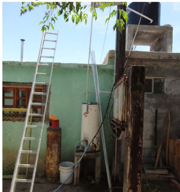
Fotografía 40. Boiler de gas en una vivienda del Dieciocho
