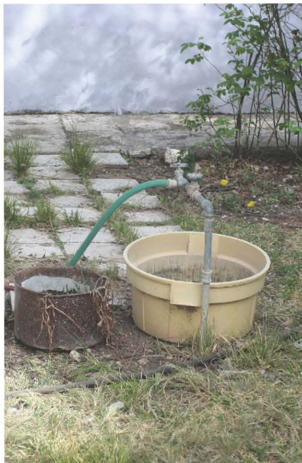
Fotografía 31. Toma domiciliaria de agua en una vivienda del Dieciocho.
