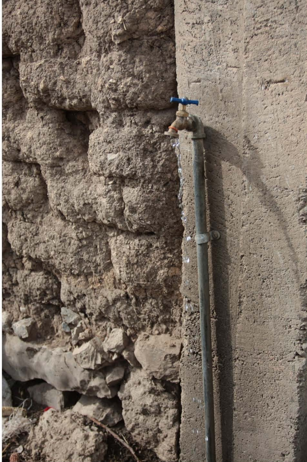
Fotografía 2 Llave con fuga en una vivienda del Dieciocho
