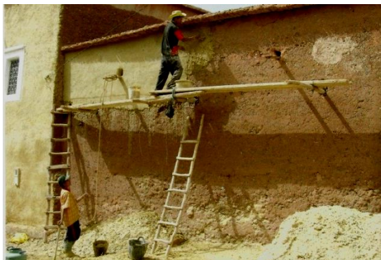
Imagen 36. Aplicación de recubrimiento a base de mortero de tierra mezclada con paja para cubrir las imperfecciones del muro y protegerlo de la erosión.
