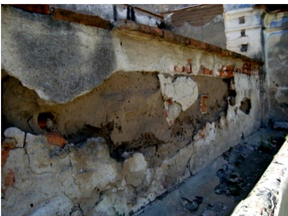
Imagen 117. Muros de tapia en corrales y área de servicios en la hacienda Santa Teresa Ixtafiyuca, Nanacamilpa, Tlaxcala.
