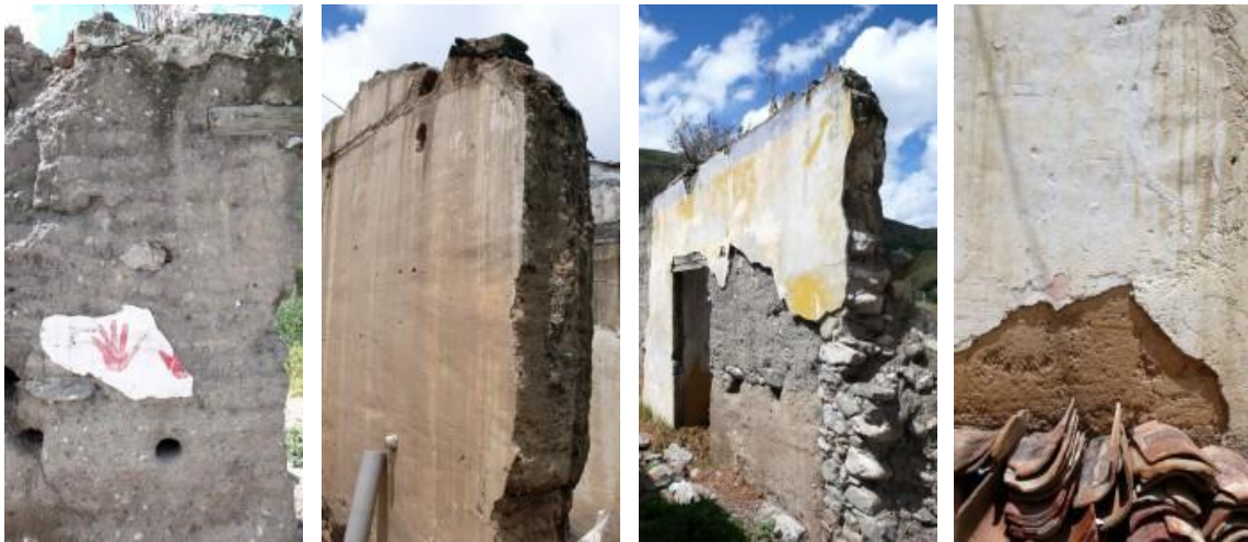
Imagen 52. Restos de muros de tapia en arquitectura virreinal de Venezuela, los cuales, en la mayoría de los casos han perdido los recubrimientos, originándose una disgregación más rápida.
