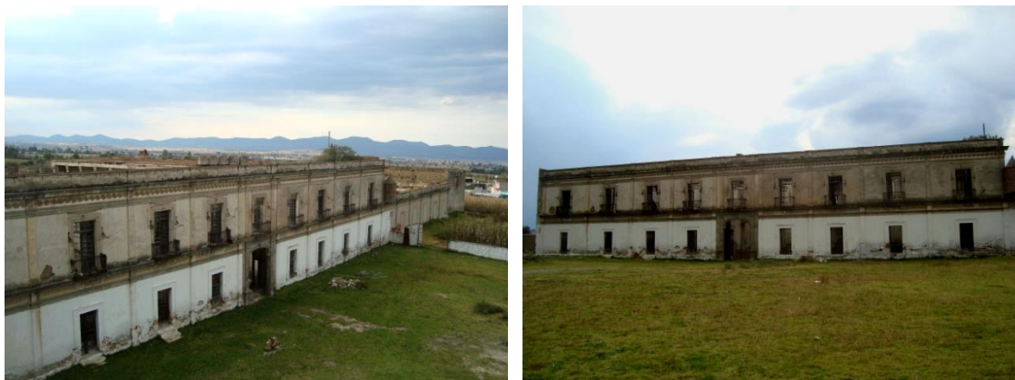
Imagen 199. Fachada principal de la casa grande de la hacienda San Antonio Mazapa, se encuentra en un avanzado estado de deterioro y actualmente está abandonada, en algunas secciones se han perdido los entrepisos y cubiertas, además de que el inmueble ha perdido puertas y viguería por el saqueo.
