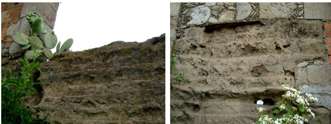
Imagen 212. Secciones de muros de tapia con presencia de humedad y erosión, se puede ver que los dentellones de mampostería y tabique forman parte de la composición de la estructura térrea.
