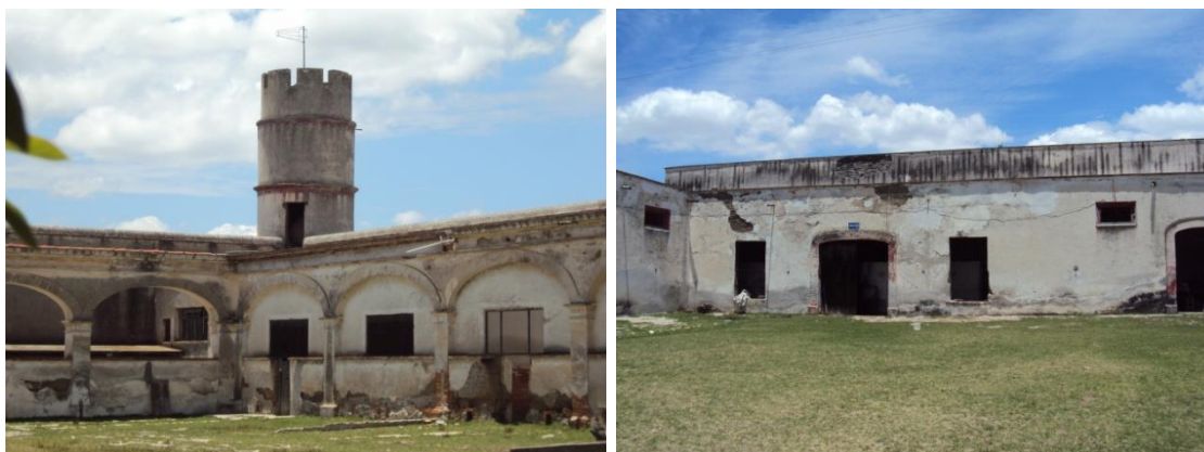
Imagen 181. Zonas de servicios en la hacienda Santa Teresa Ixtafiyuca, conformadas por corrales y caballerizas, actualmente se encuentran en desuso y el abandono ha deteriorado los muros de tapia. Fuente: Imágenes de autor.
