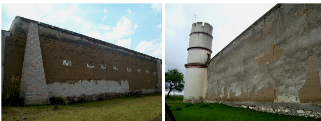
Imagen 183. Fachada posterior (norte) en la hacienda Santa Teresa Ixtafiyuca, Tlaxcala, constituida a base de muros de tapia que ha perdido los aplanados en algunas secciones y se les han colocados contrafuertes de mampostería.
