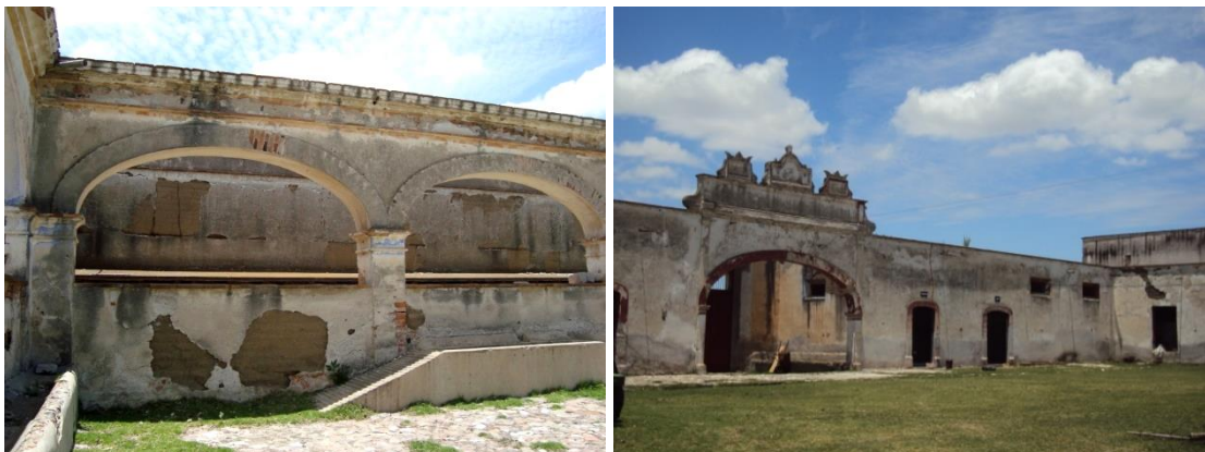
Imagen 180. Zonas de servicios en las que los muros se edificaron con tapia, actualmente en algunas secciones se han perdido los recubrimientos, policromía y en secciones se ha erosionado el muro.
