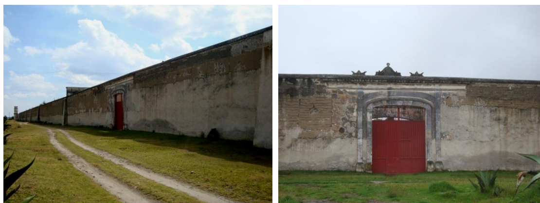
Imagen 182. Acceso posterior por la fachada norte con restos de aplanados y policromía en la hacienda Santa Teresa Ixtafiyuca. El muro perimetral en su totalidad fue erigido con la técnica constructiva de tapia. Fuente: Imágenes de autor.
