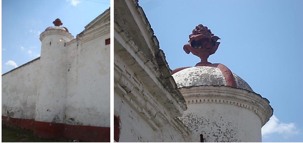
Imagen 165. Torreón de la fachada principal y detalle del remate en la hacienda San Nicolás el Grande, municipio Benito Juárez, Tlaxcala, donde se aprecian algunos deterioros. Fuente: Imágenes de autor.
