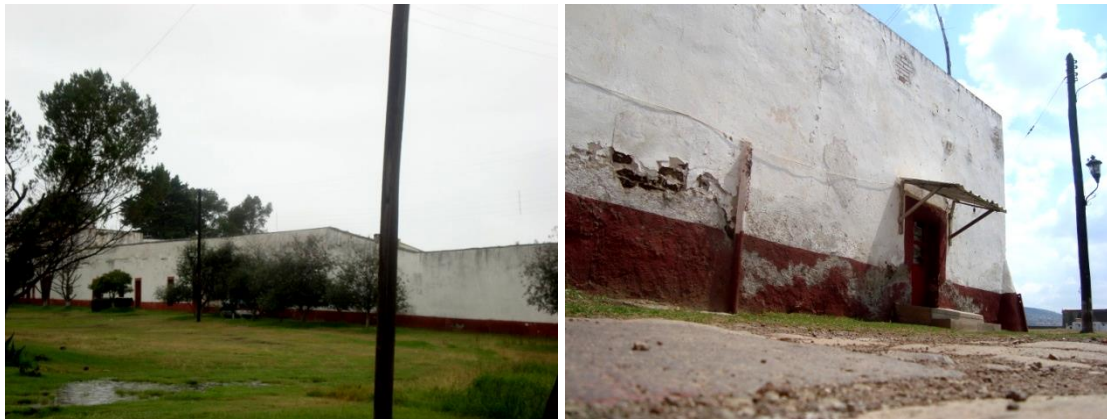
Imagen 168. Edificaciones que conforman la hacienda San Nicolás el Grande, en los muros se aprecia pérdida de aplanados y humedades.
