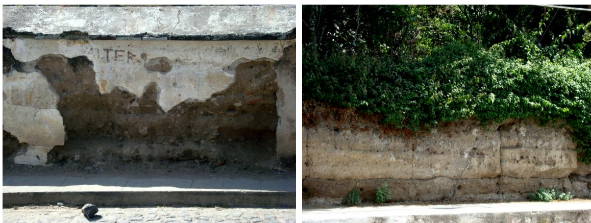
Imagen 48. En la Antigua Guatemala, Guatemala se aprecias algunos muros deteriorados de tapia y vestigios de edificaciones erigidas con éste sistema constructivo.
