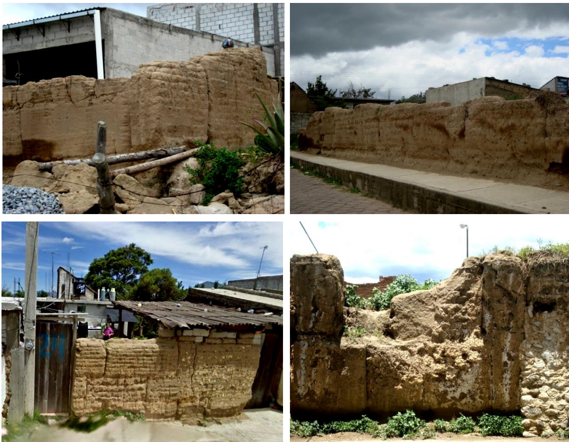
Imagen 53. Muros de tapia en el municipio de Toluca de Guadalupe, Terrenate, Tlaxcala y San Andrés Calpan, estado de Puebla, en ambos casos los inmuebles han perdido el recubrimiento casi en su totalidad y se encuentran muy deteriorados. En la actualidad se han desplazado esta técnica constructiva por materiales modernos de procedencia industrializada.
