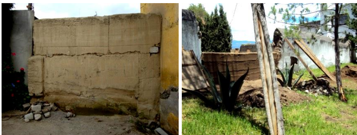
Imagen 119. Construcción de muros de tapia para la restitución de estructuras faltantes en la hacienda San Francisco Soltepec, Huamantla, Tlaxcala Fuente: Imágenes de autor.
