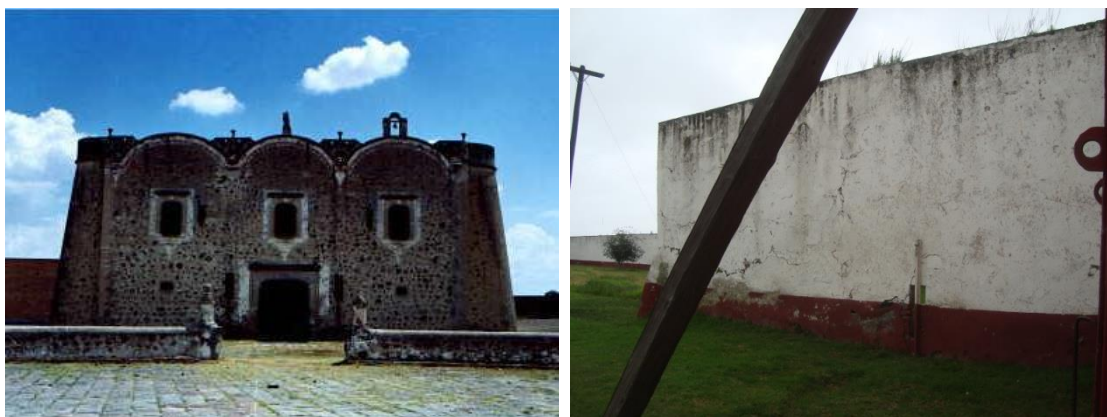
Imagen 169. Fachada principal de la troje, donde se observan los muros de mampostería sin recubrimientos y sección de muro de la casa grande, que presenta pérdida de aplanados y presencia de vegetación en el cerramiento.
