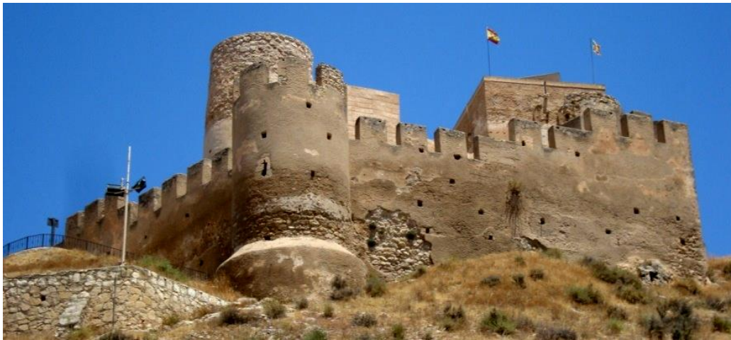
Imagen 45. Castillo de Biar, España, cuya composición de los muros es a base de tapia, algunas secciones se encuentran deterioradas, mientras que otras se han consolidado recientemente. Fuente: Imagen de autor.
