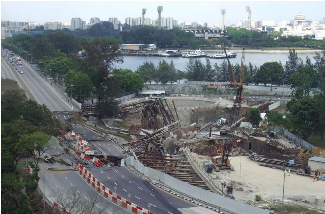
Figura 2.21 Colapso del muro de retención de la estación Nicoll Highway en Singapur en marzo del 2004.
