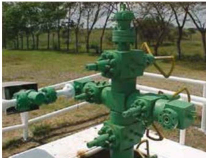
Figura 2. 6. Árbol de válvulas.
