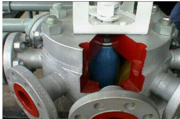
Figura 2. 9. Válvula Multipuerto en instalaciones costafuera.
