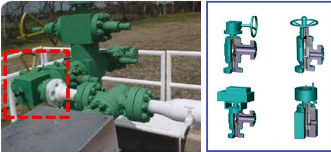
Figura 2. 7. Estrangulador en boca de pozo.
