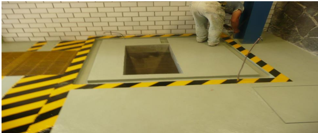
Figura 3.29. Piso de una subestación
