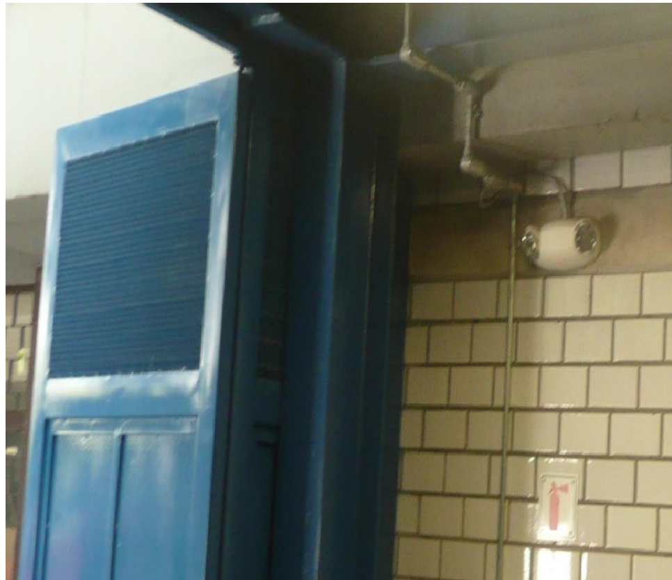
Figura 3.28. Lámpara de alumbrado de emergencia.
