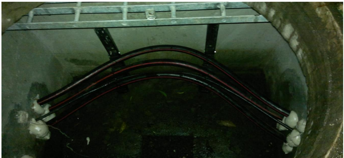
Figura 3.17. Registro y Soportes de los cables de alimentación.
