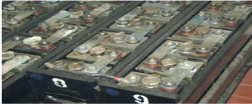
Figura 3.34. Locales de baterías.
