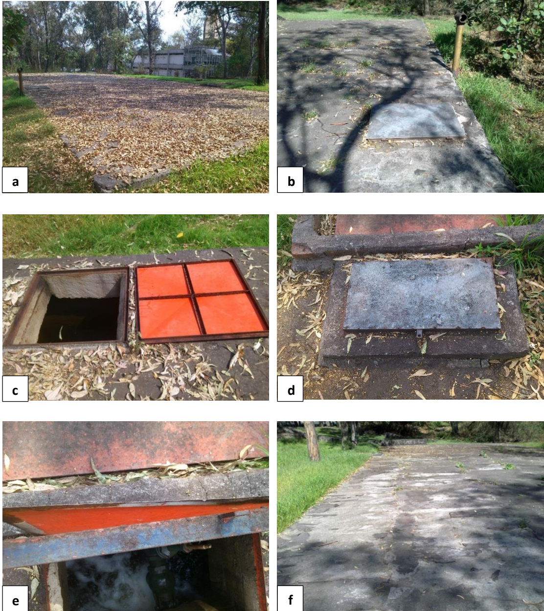
Figura 5 a, b, c, d, e, f. Cisterna Pista de Calentamiento
