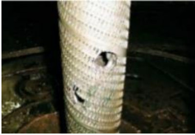
Figura 3.14. Erosión de tubería causada por arenamiento
