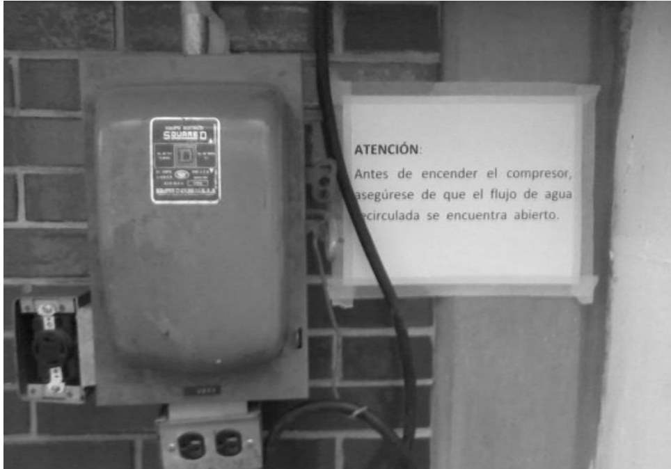
Figura IV.1-3. Toma de energía para el equipo
