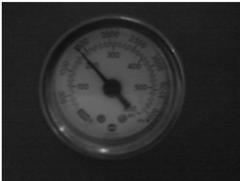
Figura IV.1-1. Indicador de presión del módulo compresor
