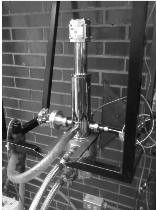
Figura IV.1-16. Módulo expensor listo para interconectarse con el resto del sistema
