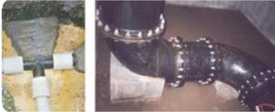
Imagen 1.5.1. Atraques de concreto
