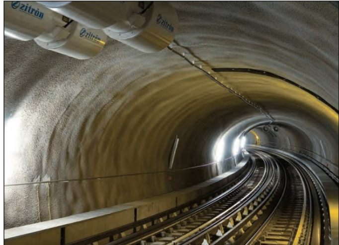
Figura 5.2 Revestimiento definitivo de concreto lanzado en el túnel Viret, Suiza. [11] BASF Corporation (2013).
