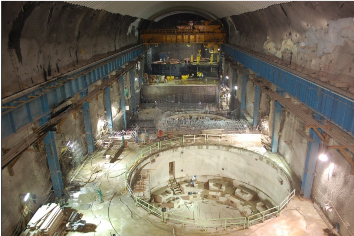
Figura 6.29 Vista de la Casa de Máquinas en el piso superior, elev. 393.20. En la parte superior se observa un techo arqueado de lámina, colocado para captar el agua filtrada por los drenes en la bóveda, y proteger el equipo electromecánico e instalaciones dentro de ésta.
