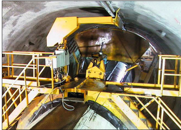
Figura 3.49 Robot para colocación de concreto lanzado como parte del equipo de apoyo. [105] Tunnel .
