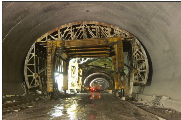
Figura 5.13 Cimbra metálica telescópica, utilizada en el revestimiento del túnel carretero El Sinaloense, México. [97] Obrasweb.
