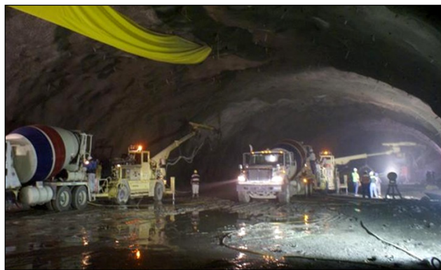
Figura 6.18 Colocación de concreto lanzado para revestimiento definitivo en la bóveda de la Casa de Máquinas, con la ayuda de equipos robotizados.
