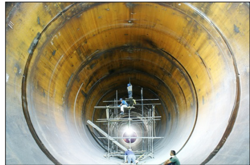
Figura 6.7 Interior de la tubería a presión, rama horizontal, en la construcción de la C. H. La Yesca.
