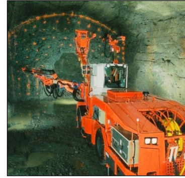
Figura 3.1 Perforación en sección de túnel con ayuda de una plantilla. [60] López Jimeno (2011).
