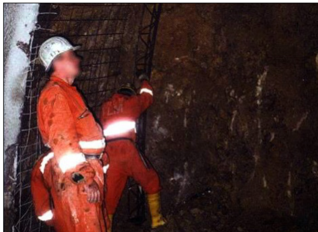
Figura 4.25 Colocación de marcos reticulados de tres barras. Se observa la malla electrosoldada ya colocada en las paredes y una zona con el concreto lanzado ya colocado. [82] TEDESA.
