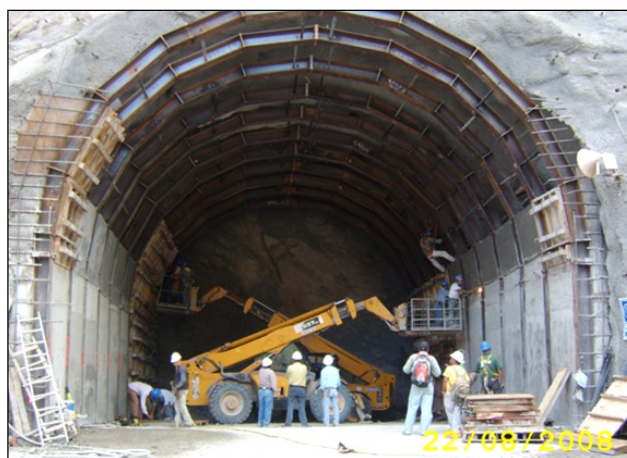
Figura 6.12 Inicio de la excavación de los túneles de acceso a la Casa de Máquinas. Se aprecian los marcos de acero retacados con concreto, para el soporte de la excavación en la entrada del túnel.
