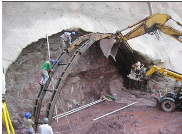
Figura 4.18 Colocación de marcos metálicos para soporte en la construcción del túnel El Sinaloense, México. [97] Obrasweb.
