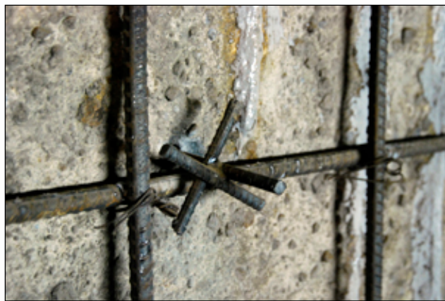
Figura 5.4 Barras de acero de refuerzo y un escantillón de acero como guía para colocar el recubrimiento adecuado de concreto lanzado. [95] Lumbreras y Túneles .
