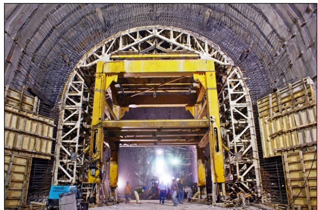
Figura 5.15 Preparativos para la colocación del revestimiento con cimbra metálica telescópica, en una zona del túnel de desvío No. 1, en la construcción de la C. H. La Yesca.
