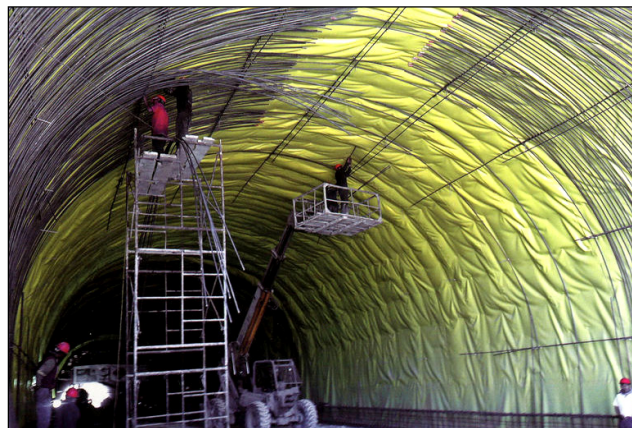
Figura 5.1 Colocación de acero de refuerzo para revestimiento con concreto armado colado en sitio. Se aprecia en la foto una membrana impermeabilizante colocada previamente. Túnel de la carretera Durango-Mazatlán, México. [97] Obrasweb.
