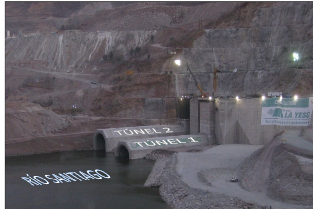
Figura 6.3 Portales de entrada de los túneles 1 y 2 de desvío, durante la construcción de la C. H. La Yesca.
