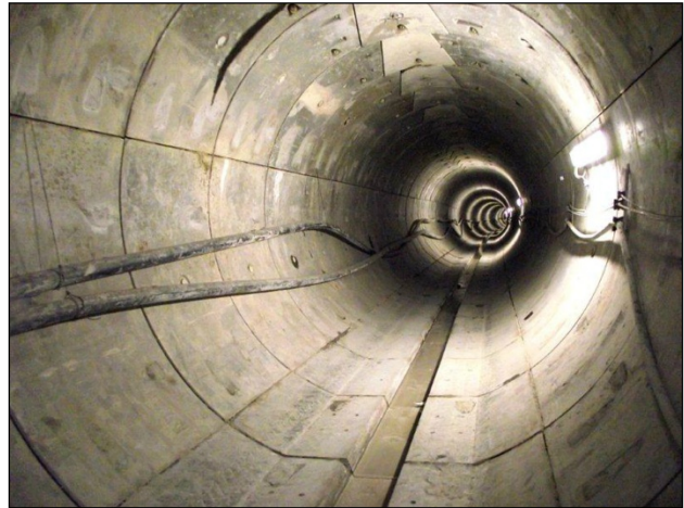
Figura 5.20 Revestimiento en túnel con anillos de dovelas. Se observa que cada anillo está formado por dos dovelas corrientes, dos de contrallave, en la plantilla una dovela de piso y la llave. [92] Geocontrol .
