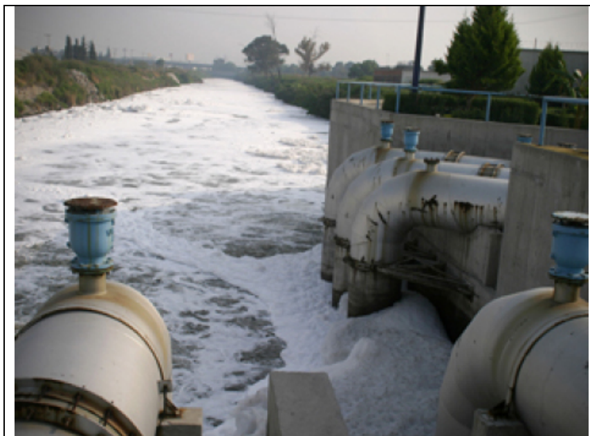
Figura 30 – Vertido de Aguas Negras - Valle de Tula, Hidalgo.
