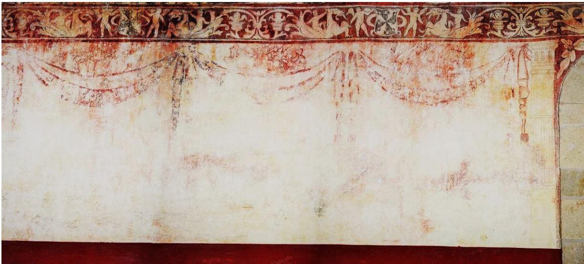
Ilustración 17. En la tercera etapa pictórica se plasmaron, en la parte central del muro, ricos cortinajes desplegados a lo largo de las paredes, los cuales surgían de la boca de un felino y se iban extendiendo entre anillos y cabezas de león. Claustro alto de Tlaltzapán, Morelos (arriba); corredor del claustro bajo de Tepoztlán, Morelos (en medio); corredor del claustro bajo de Tetela del Volcán, Morelos (abajo) (Fotografías Aban Flores Morán, 2013).
