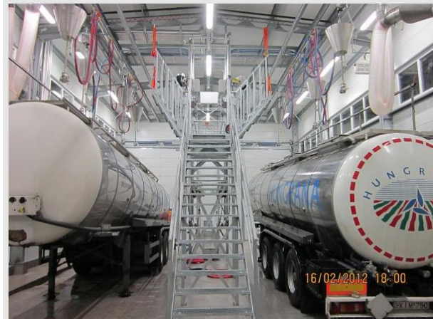
Figura 5.1 Área de lavado de autotanques de OMZ Plantas de lavado industrial, Italia.
