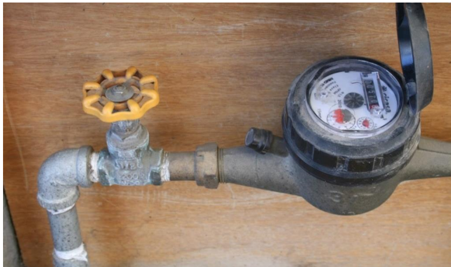
Figura 1.8 Medidor en una toma domiciliaria
