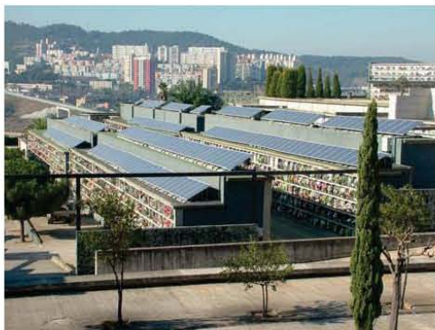
Imagen 39.- Celdas solares sobre los nichos 22
