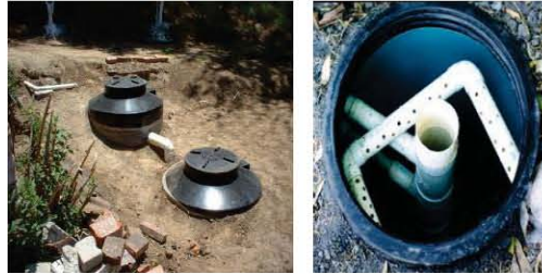
Imagen 64 y 65.-Filtro Biológico para Aguas Jabonosas 48
