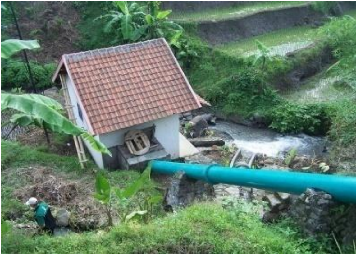
Figura 3.16 Casa de maquinas en una mini-central hidroeléctrica
