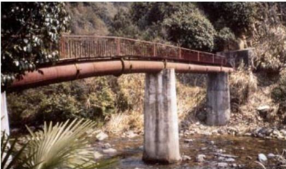
FIGURA 3.13. Puente-canal en tubería de acero
