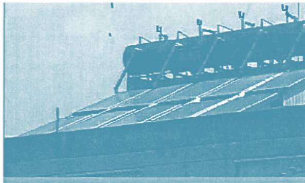
Imagen tomada por Edgar León Cacho, fachada general del sistema de calentamiento de agua en la azotea.
