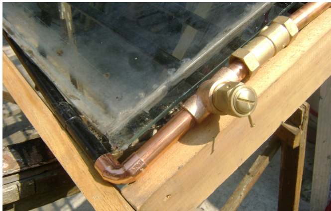
Imágenes donde se muestra, las dos válvulas instaladas en la tubería de cobre, la válvula de alivio está instalada con una conexión tipo Tee, imágenes tomadas por el autor. © Daniel E. García Flores.
