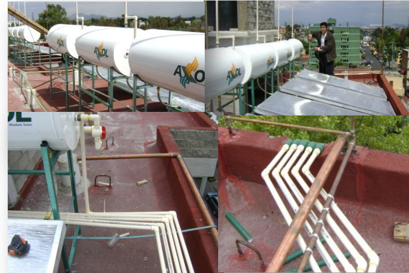
Imágenes de calentadores solares instalados en azoteas de edificios de vivienda. © Daniel E. García Flores.
