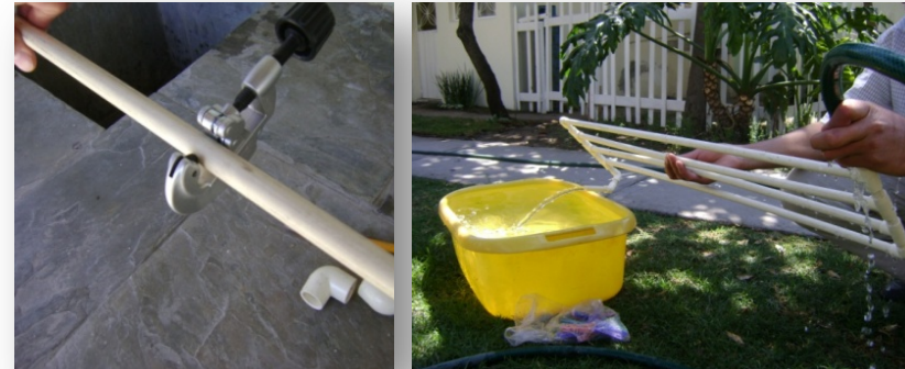
Imágenes donde se aprecia el corte del tubo hidráulico de CPVC de 1/2" y ya en funcionamiento el primer modelo de la tubería del colector solar D.R. © Daniel E. García Flores.
