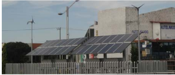
Figura 16. Sistema híbrido ubicado entre Río las Avenidas y Francisco I. Madero Fuente: Tomada por Cristina Olmedo Santiago, 2014.
