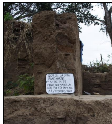
Fig. 41. Puerta tapiada del cuarto de acceso. La Joya, febrero 2007, (Archivo del proyecto ECV).
