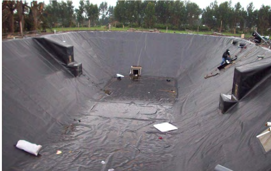
Figura 5.3. Laguna cubierta de polietileno de alta densidad (HDPE).
