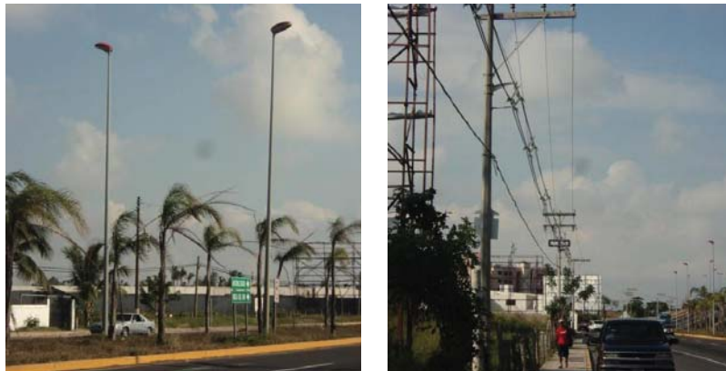
FIGURA 58. Alumbrado público y cableado eléctrico en la vialidad principal
