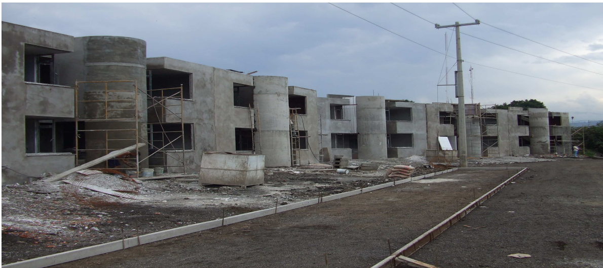
Anexo "B" Cimbrado para contener el concreto hidráulico de la pavimentación del fraccionamiento Las Lomas .
