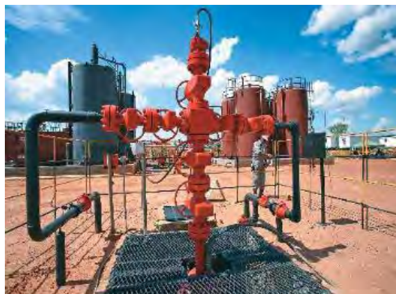
Figura A.2 Árbol de válvulas conectado a dos líneas de descarga.
