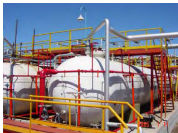
Figura A.16 Tanques de almacenamiento para gas.
