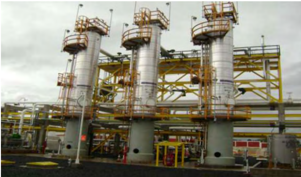
Figura A14 Torres de estabilización.
