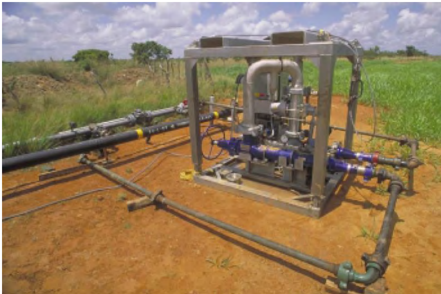
Figura II.24 Medidor Vortex instalado en una línea de descarga.
