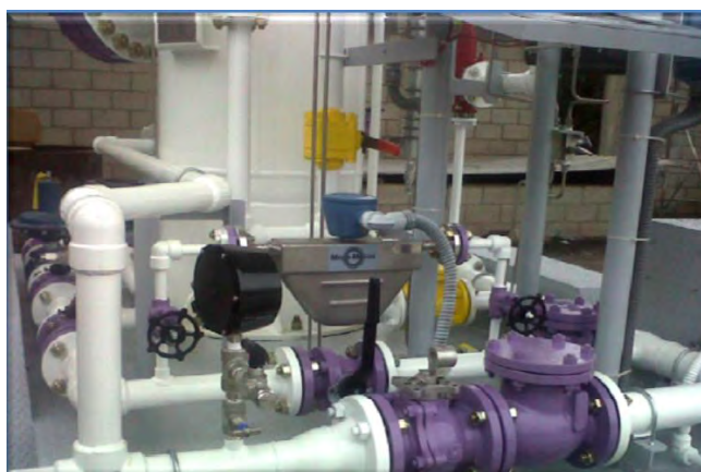
Figura I.3 Medidor tipo Coriolis instalado en una batería de separación.
