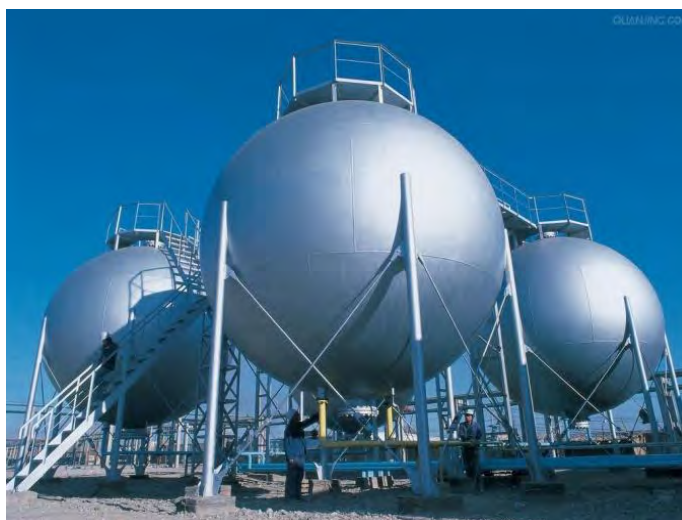
Figura II.37 Tanques presurizados esféricos para almacenamiento del gas.
