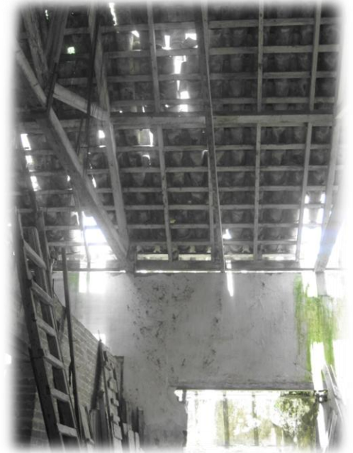
Fotografía que muestra una casa tlacotalpeña en deterioro por abandono
